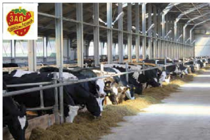
СОВХОЗ им. ЛЕНИНА (Московская обл.) PANDORA LED 505PE-240, СИСТЕМА ПОД PLC-УПРАВЛЕНИЕМ С 2016 Г.
